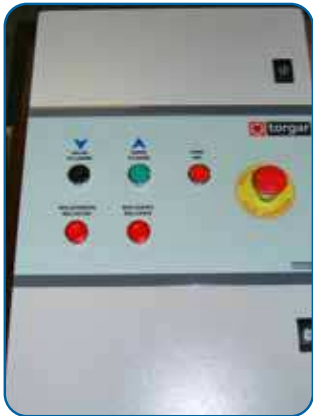
Cuadro de control exterior External control Panel
