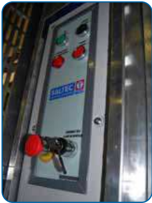
Cuadro eléctrico interior Internal control panel
